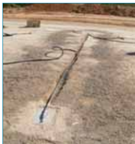
Figura 12. Fotografía instalación célula de carga.
