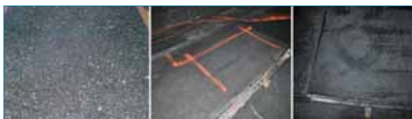
Figura 19: Estado superficial de la mezcla bituminosa: antes del ensayo (izq.), después del ensayo de fuego, blanco (medio) y mezcla aditivada (dcha.)
