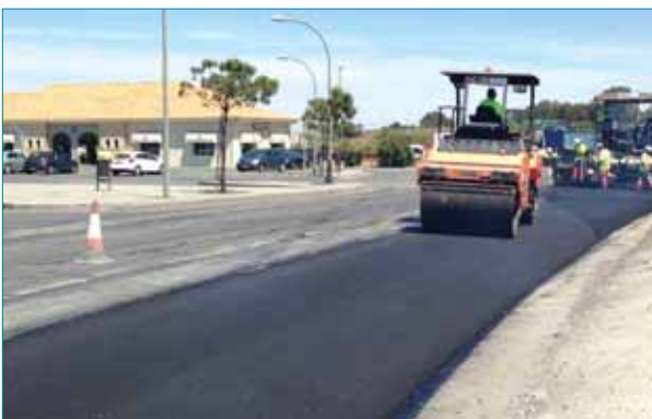
Figura 10. Compactación de la mezcla en la reposición de la capa fresada previamente.
