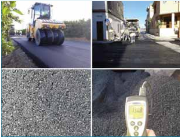
Figura 7: Imágenes de obra en Pedralba ejecutadas con mezclas recicladas semicalientes con espuma de betún.
