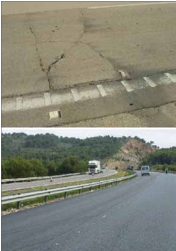
Figura 1: Firme fisurado antes y después del tratamiento con betunes modificados de altas prestaciones.
