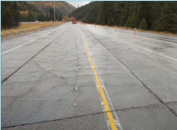
Foto 1. Pavimento de hormigón fracturado (Fuente: Antigo).
