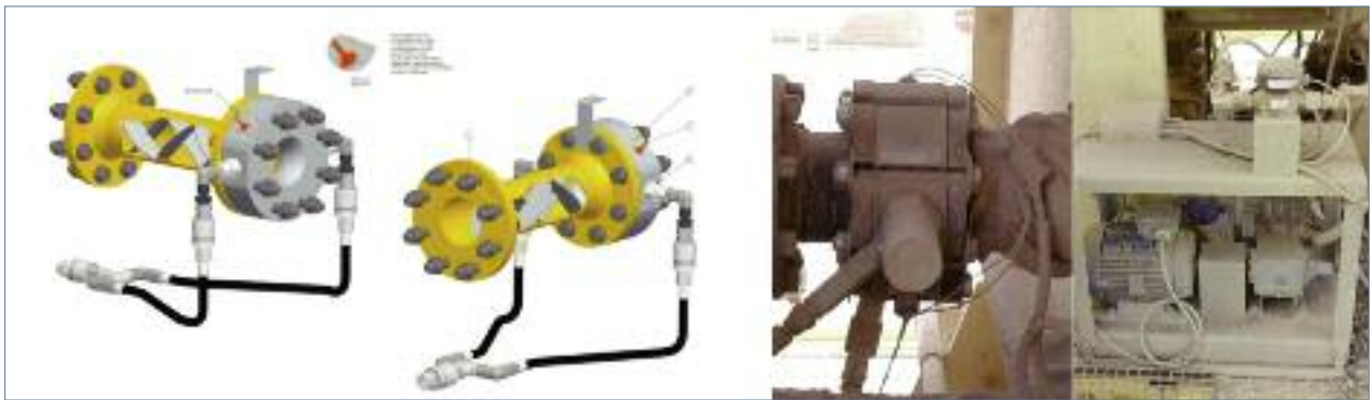
Figura 2: Esquema de la rampa de respumación y fotografías del sistema de espumado BITFOAM en planta.
