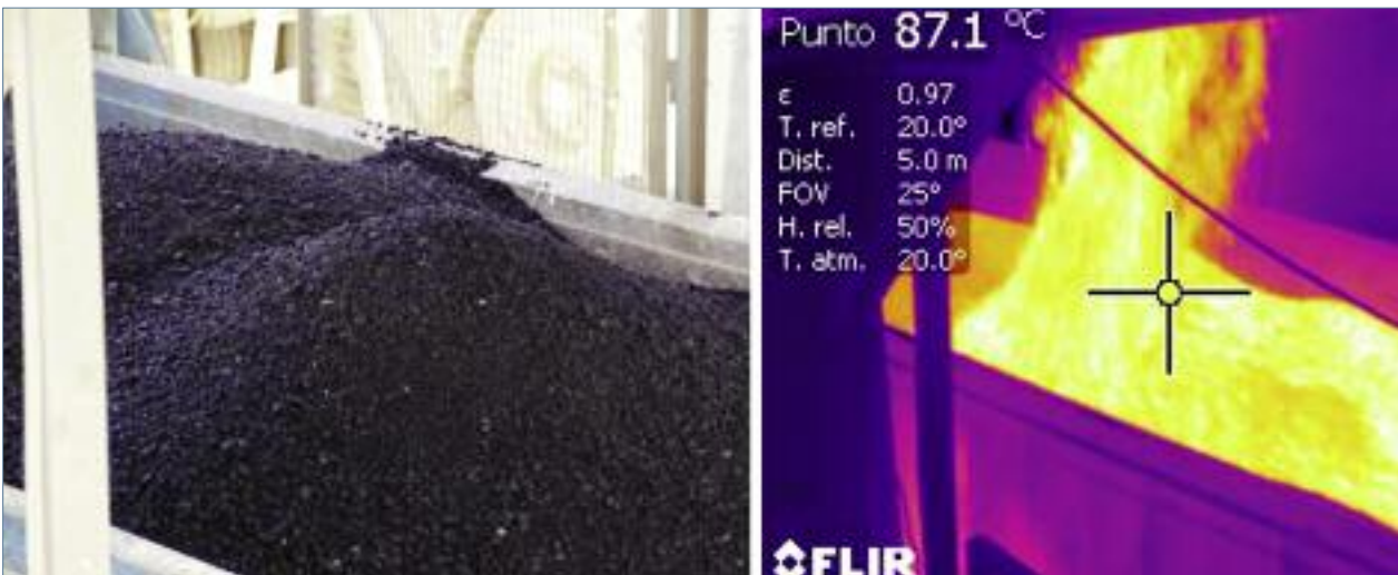
Figura 9: Mezcla reciclada templada a tasa total. Ausencia total de humos. Tª salida mezclador: 94.2°C.
