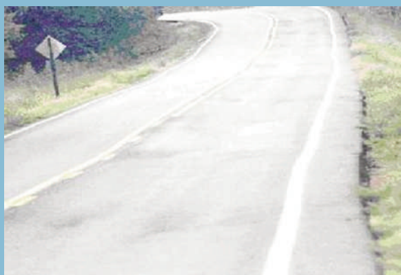
Figura 1. Carretera con mala regularidad superficial.
