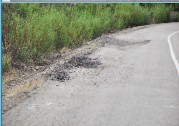
Figura 7. Aspecto de distintas patologías en una carretera.
