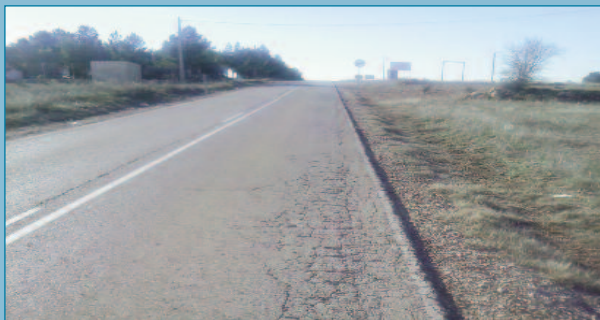
Figura 13. Rodera formada por asentamiento de las capas granulares inferiores del firme.
