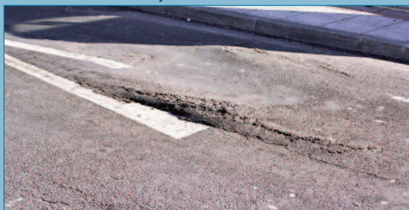
Figura 11. Deformación por vertido de combustibles que altera sensiblemente la mezcla bituminosa.
