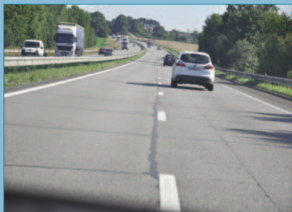
Figura 8. Grietas reflejadas de las existentes por retracción en las capas inferiores del firme.
