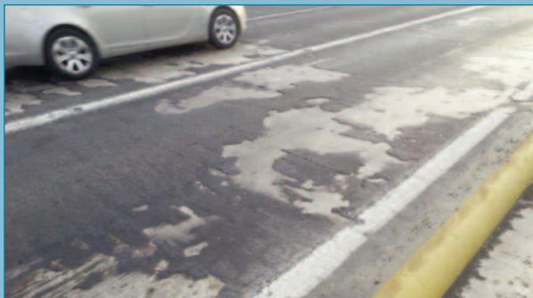
Figura 100. Peladuras en capas bituminosas muy delgadas sobre pavimento de hormigón.
