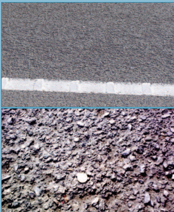
Figura 91. Patología de descarnadura y detalle de la misma.
