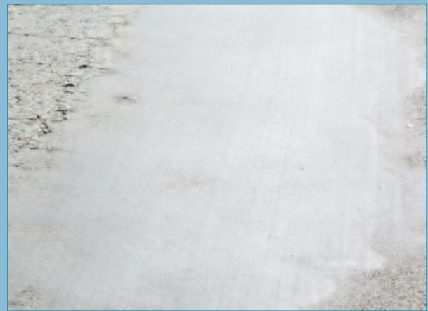
Figura 105. Exceso de ligante en ejecución de un bacheo.
