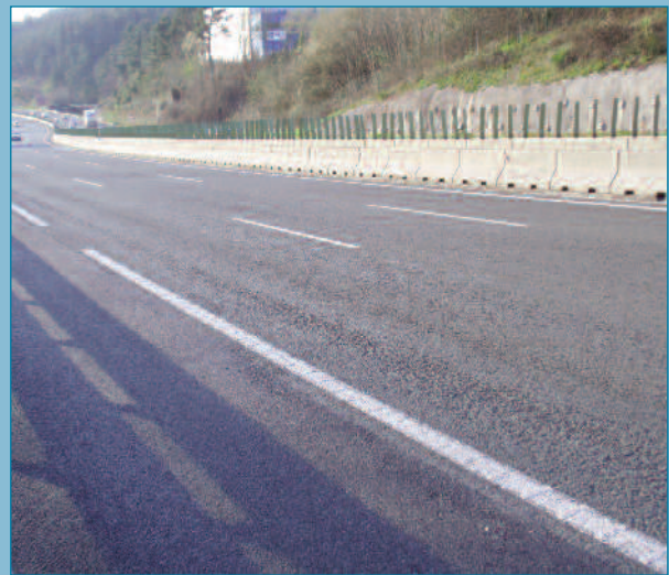
Figura 92. Descarnadura en fase inicial.
