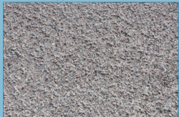
Figura 93. Descarnadura en fase avanzada y con árido suelto
