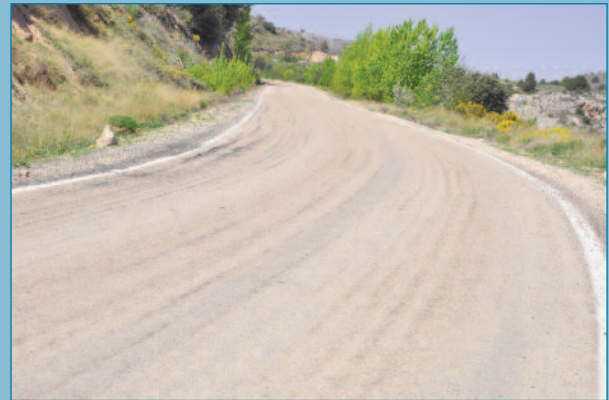
Figura 99. Peladuras en capas de tratamientos superficiales de riegos con gravillas.
