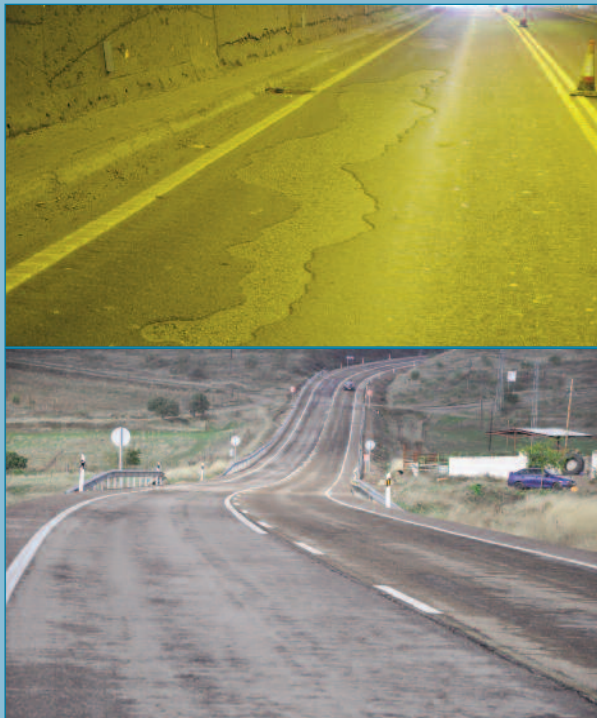
Figura 98. Peladuras en capas de lechadas bituminosas o microaglomerados en frío.
