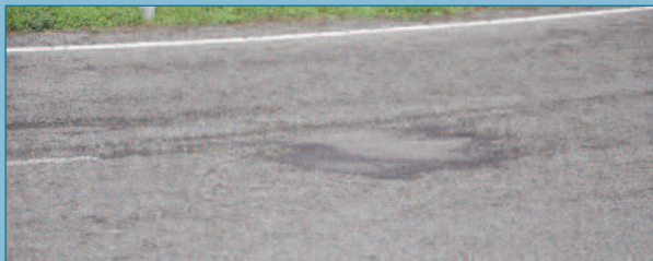
Figura 97. Pérdida total de la capa de rodadura en una descarnadura.
