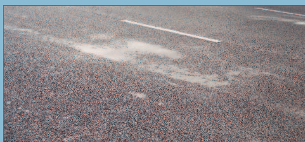
Figura 107. Nivel de severidad Bajo.
