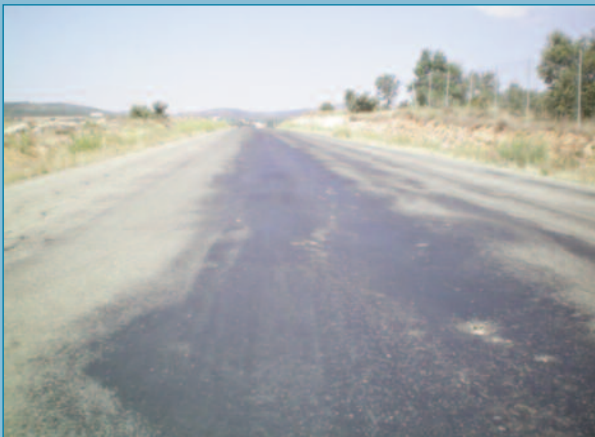
Figura 104. Exudaciones por mala ejecución de riegos superficiales con gravillas.
