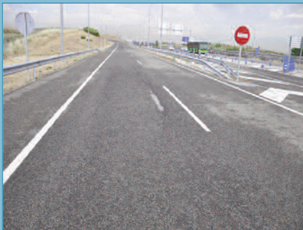
Figura 94. Descarnadura avanzada con formación de bache.
