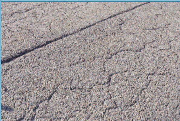
Figura 123. Diversos casos de vertidos superficiales de combustibles y afecciones al firme.
