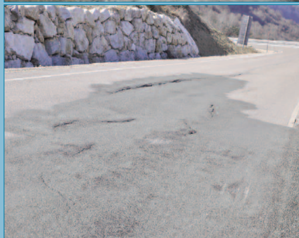
Figura 119. Escalón debido a asentamiento localizado de las capas inferiores.
