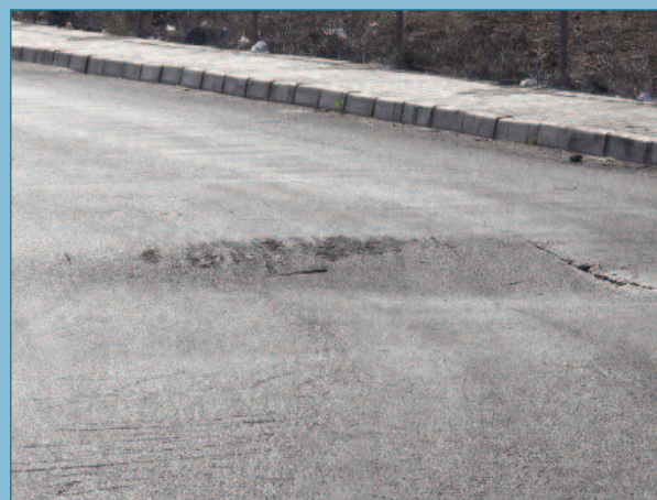
Figura 117. Escalón localizado en un punto de la vía.
