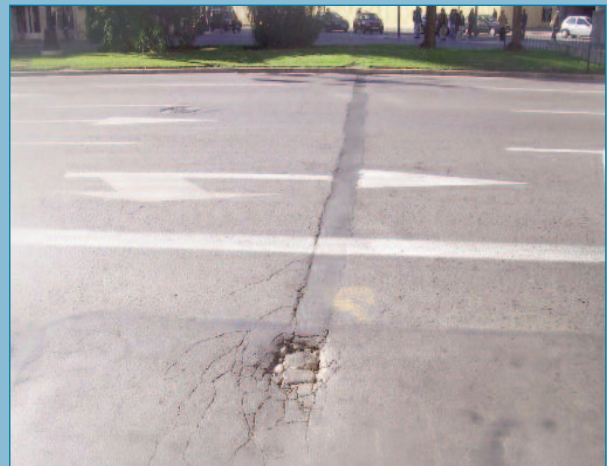
Figura 122. Escalón producido por asentamiento de zanja mal reparada.
