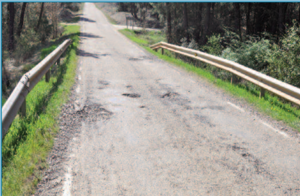
Figura 115. Ejemplos de la patología de baches.
