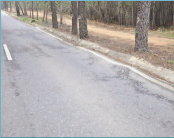
Figura 121. Escalones producidos por afección al firme de las raíces de los árboles próximos a la carretera.
