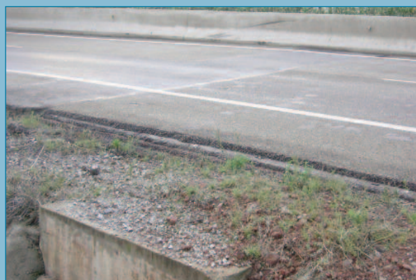
Figura 120. Escalón producido por la presencia de una estructura.
