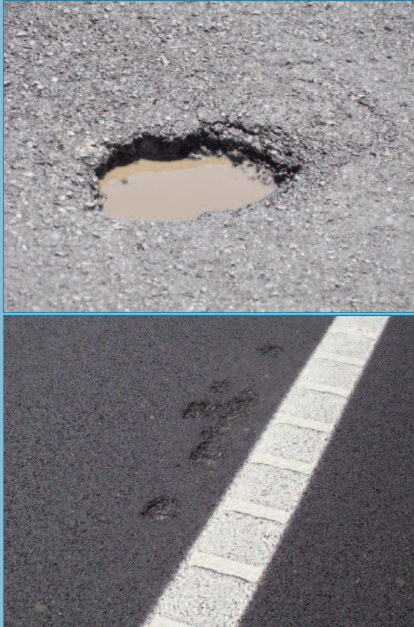
Figura 116. Más ejemplos de la patología de baches.
