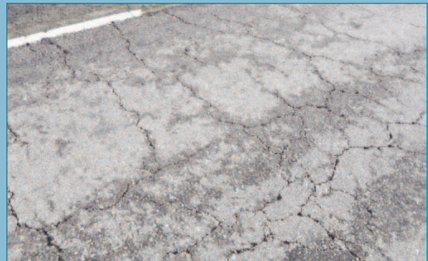
Figura 124. Agrietamiento de la capa de rodadura afectada por el vertido de sales como tratamiento anti hielo y las bajas temperaturas.
