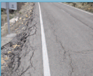
Hundimiento por fallo en el terraplén
