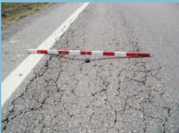
Blandón donde se aprecia el hundimiento del firme
