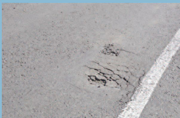
Hundimiento localizado por defecto del drenaje
