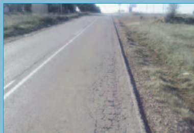
Rodera por asentamiento de las capas granulares inferiores del firme
