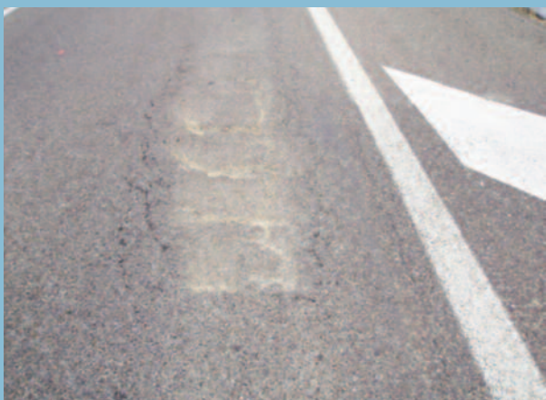
Blandón en el que se aprecia el bombeo de finos.
