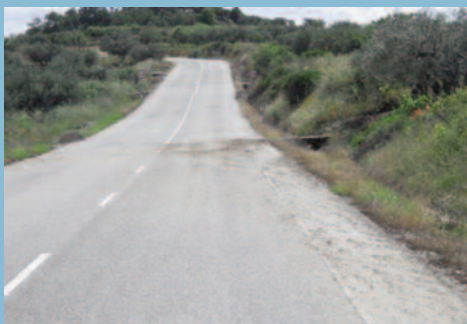
Arcén sucio, con arrastres
