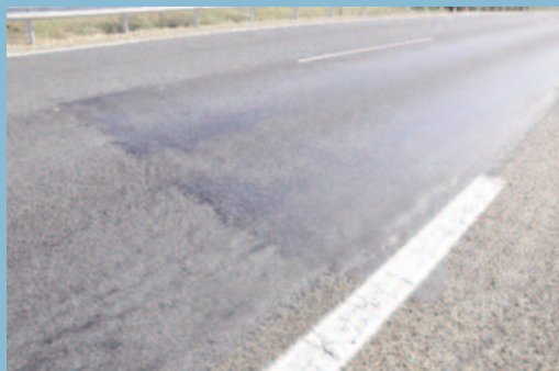
Exudación en un tratamiento con microaglomerado en frío
