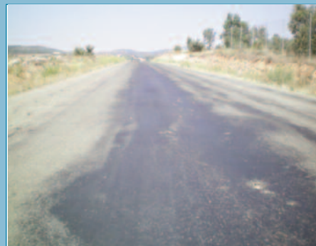
Exudación con nivel de severidad alta
