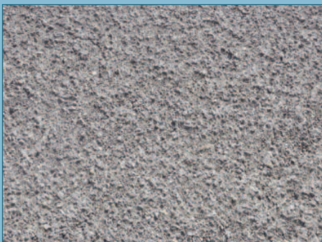
Descarnadura en fase avanzada y con árido suelto
