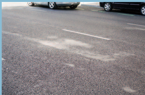
Exceso dotación del riego de adherencia
