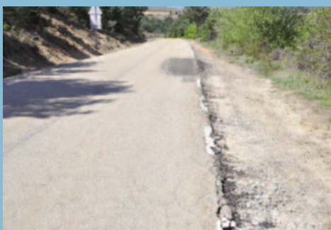
Arcén inutilizado por mordiente en mal estado
