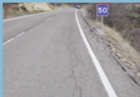
Arcén agrietado por asiento de terraplén
