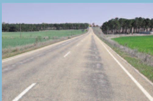
Peladura generalizada en una capa de lechada bituminosa
