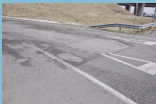
Descarnadura en fase avanzada con pérdida parcial de la capa de rodadura
