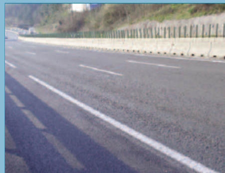
Descarnadura en fase inicial
