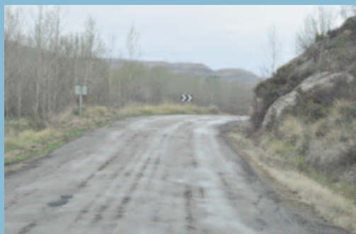
Peladuras en tratamientos superficiales de riegos con gravillas
