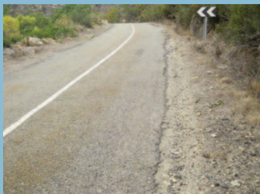
Arcén inexistente, y calzada reducida por mordientes laterales deteriorados
