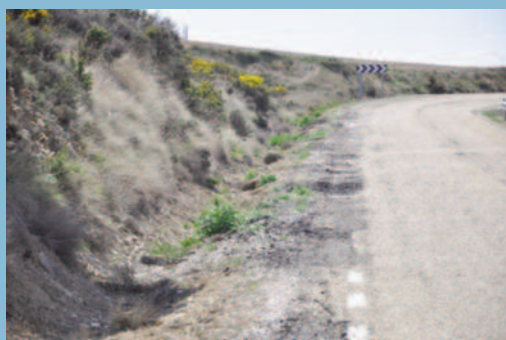
Arcén en mal estado no utilizable
