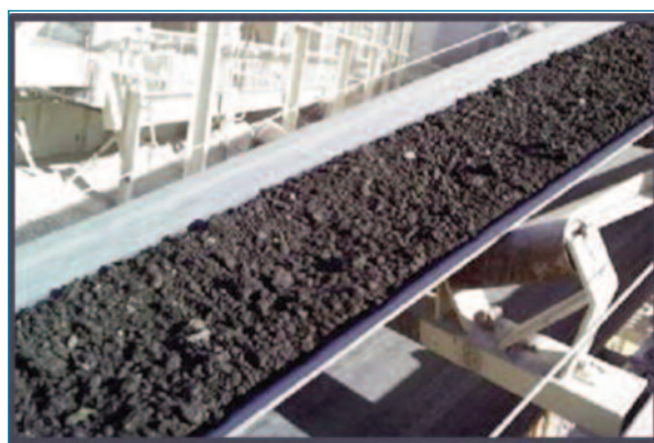
Figura 3: Cinta transportadora para incorporación a mezclador de materiales granulares
