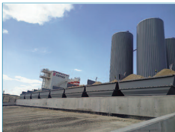
Imagen 16 Tolvas de alimentación de los áridos en frío
