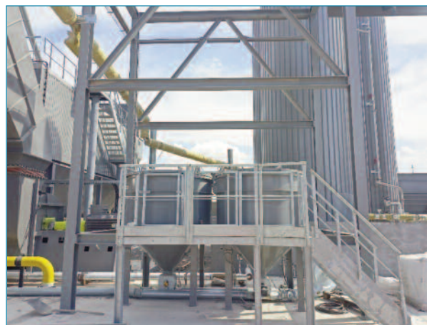
Imagen 13 Doble silo de almacenamiento de aditivos sólidos.
