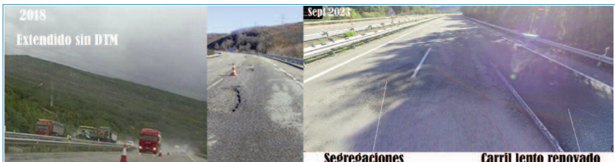
Figura 3. Puesta en obra en condiciones inadecuadas, sin DTM, y resultado de muy baja durabilidad.
