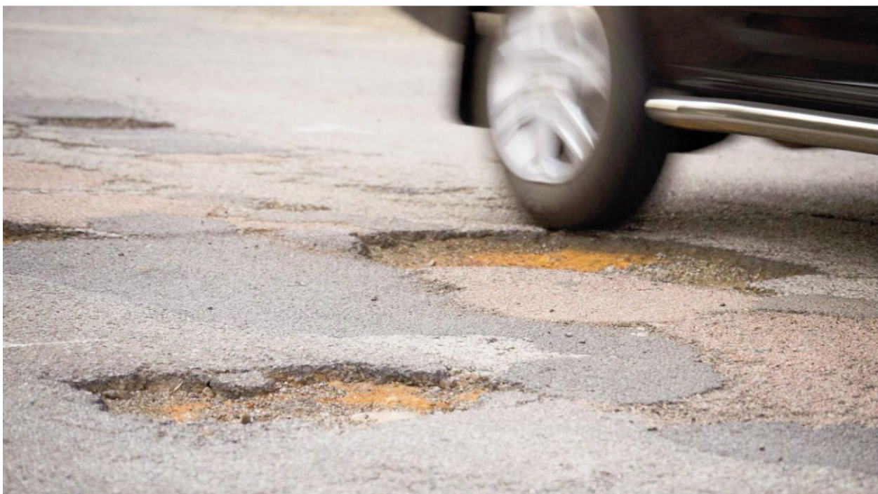
Socavones en el asfalto de una carretera española. | Getty Images
